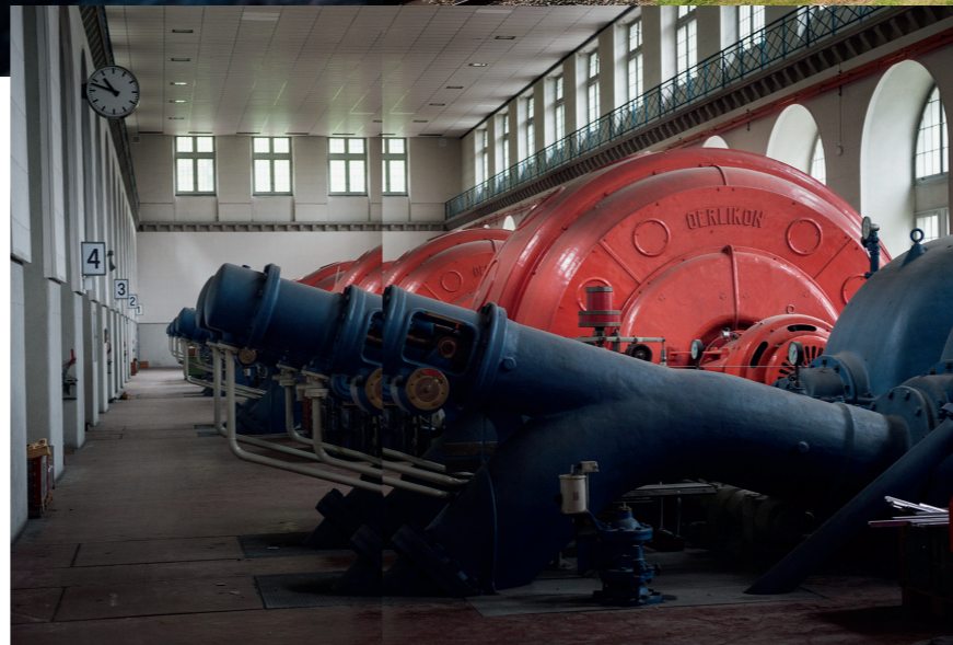
Maschinenhalle des Wasserkraftwerk Amsteg.
